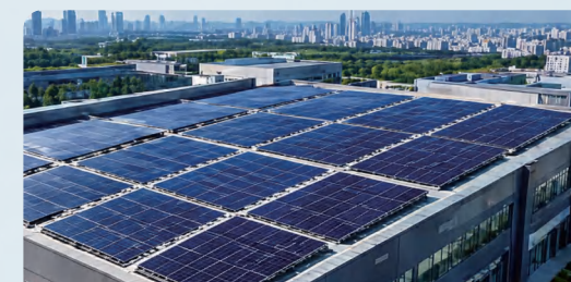
工商业屋顶光储方案
